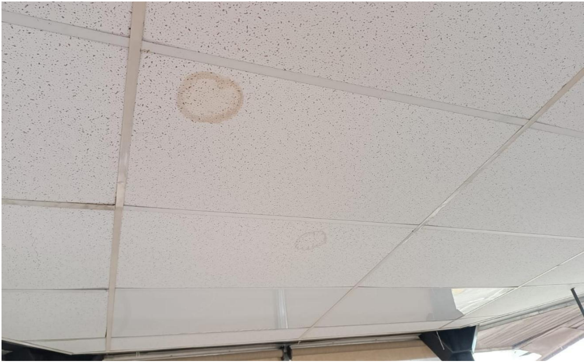
CIELO RASO DE LA TORRE DE CONTROL CON RESTOS DE ANIMALES
