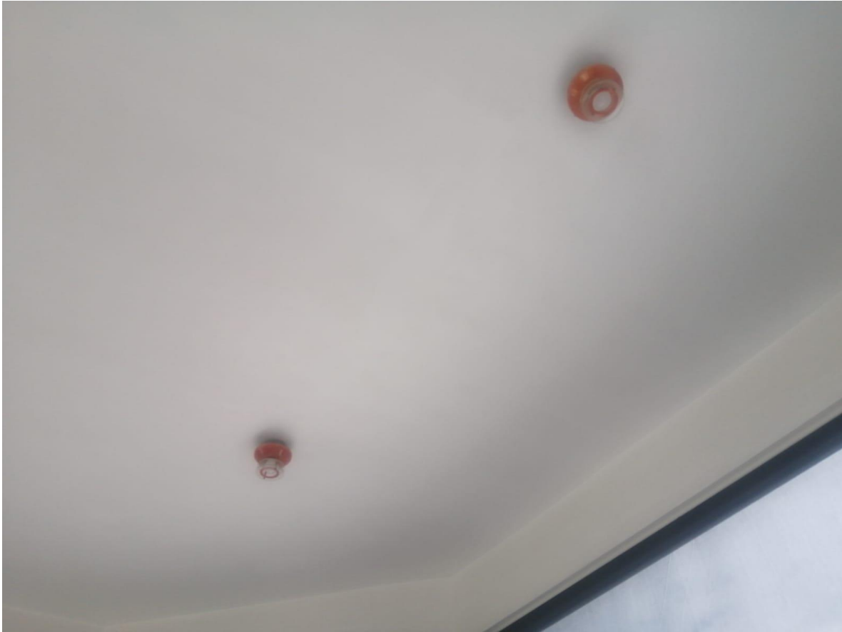
ILUMINARIA TORRE DE CONTROL
